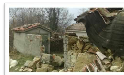
Figura 6- Cimitero di San Tommaso Post Sisma
