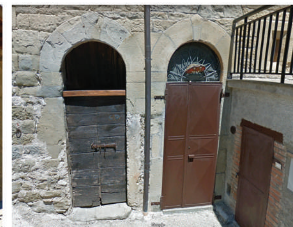
C Doppia apertura ad arco a tutto sesto con conci in pietra a facciavista
